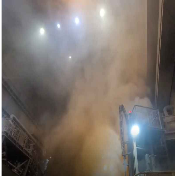
[ FUME의 발생량이 증가하자 지붕에 설치된 HOOD로 포집되지않고 천정에 정체된 FUME 다른 공정으로 퍼져나가는 사진-1 ]
